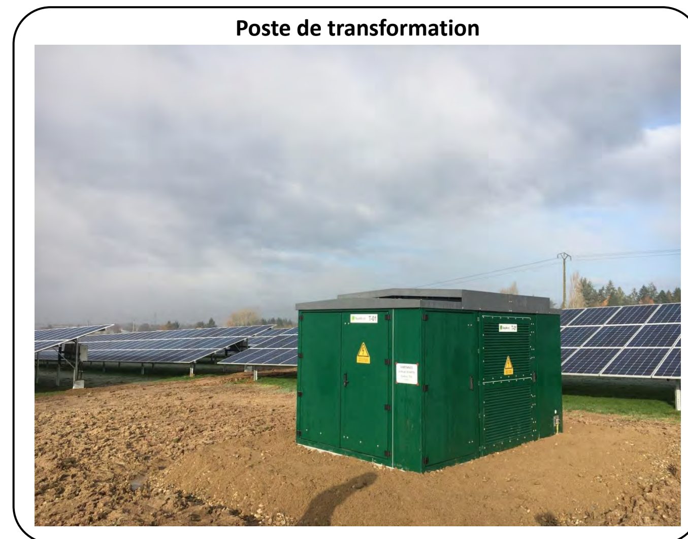
Photographie 2 : Poste de transformation
