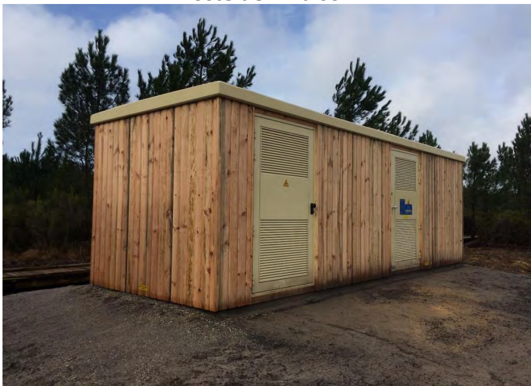
Photographie 3 : Poste de livraison bardé de bois
